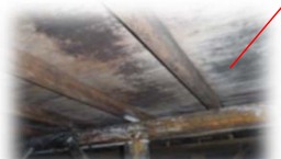
床下木材面のカビ調査
